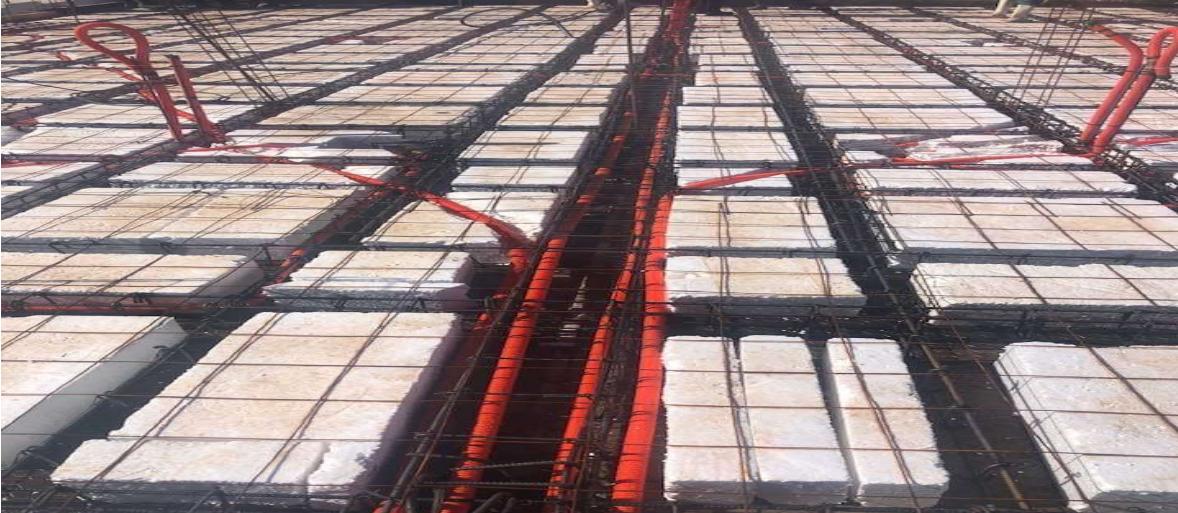
Figura 4.2 Ramal de tubería Conduit.
