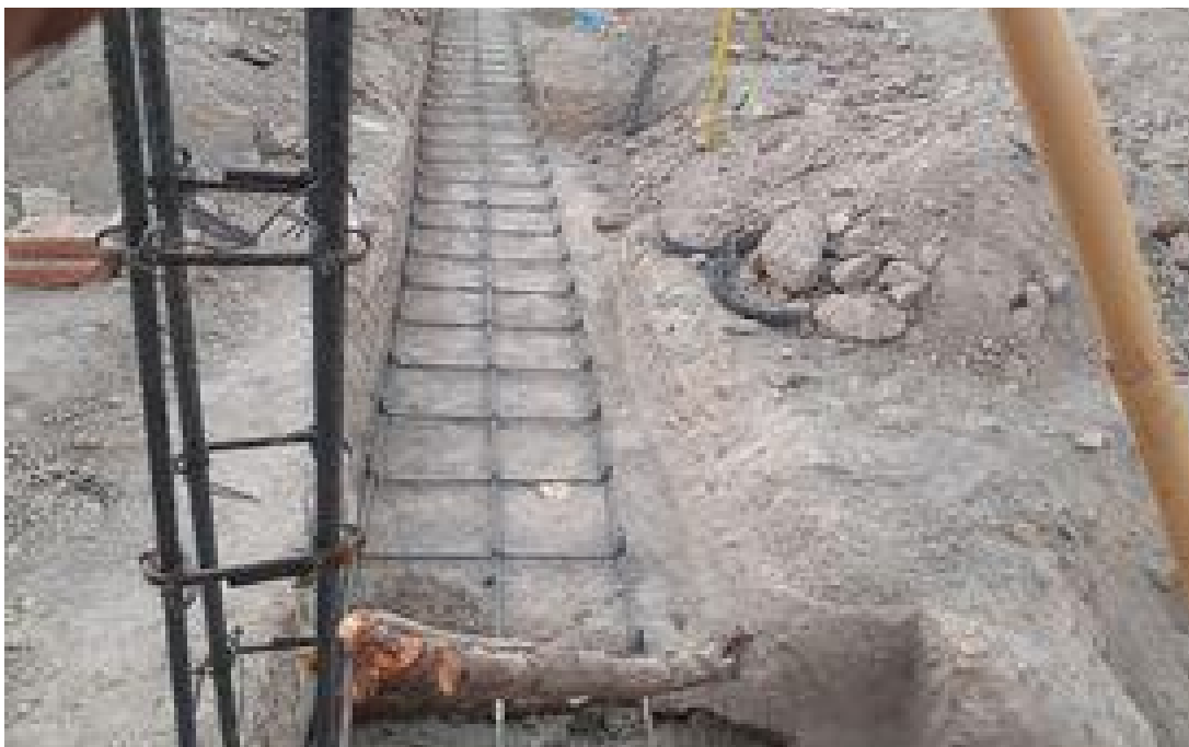
Foto 15: Las parrillas y cadenas de acero se ocupan como cimientos, pero comúnmente construyen las casas con mampostería. Xochitepec, Mor., Cristian Salas Juárez, 2022.
