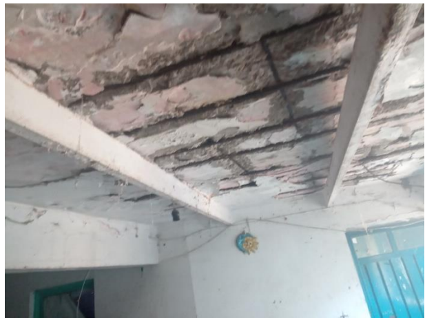
Ilustración 2. Losa con varilla expuesta, repellado descascarado y con problemas de humedad. (18.952114, -98.979683).
