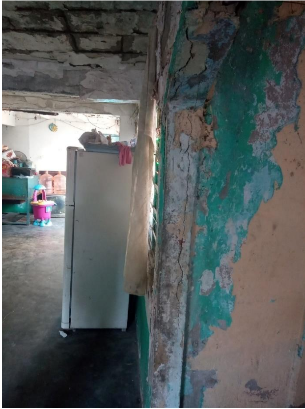
Ilustración 5. Grietas de separación en la losa y trabe. (18.952114, -98.979683).
