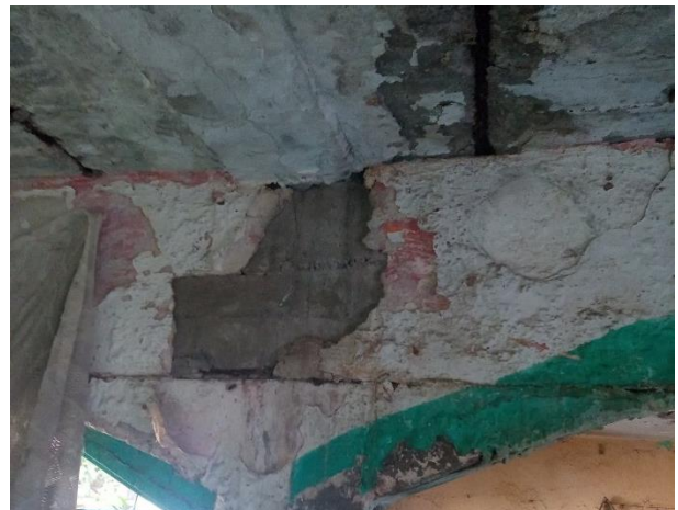
Ilustración 8. Grietas en uniones entre trabe y columna. (18.952114, -98.979683).
