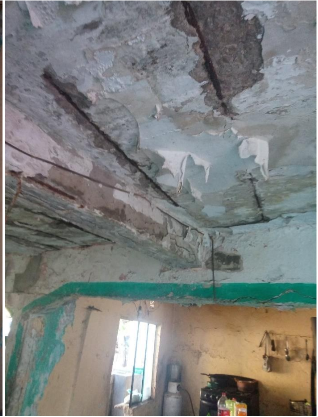
Ilustración 6. Grietas de separación en la losa y trabe. (18.952114, -98.979683).
