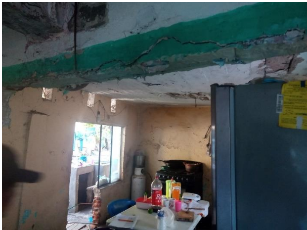
Ilustración 7. Grietas en uniones entre trabe y columna. (18.952114, -98.979683).
