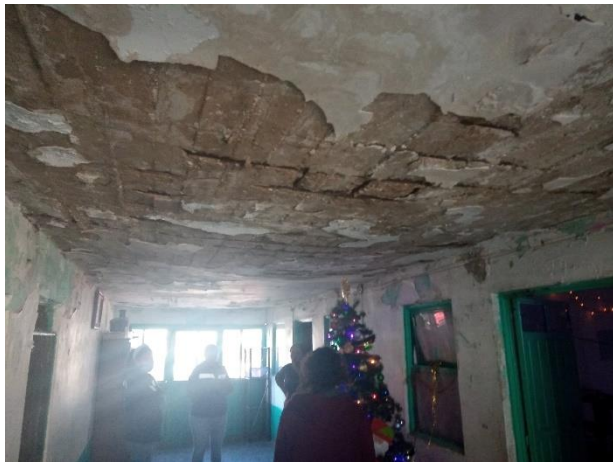
Ilustración 1. Losa con varilla expuesta, repellado descascarado y con problemas de humedad. (18.952114, -98.979683).
