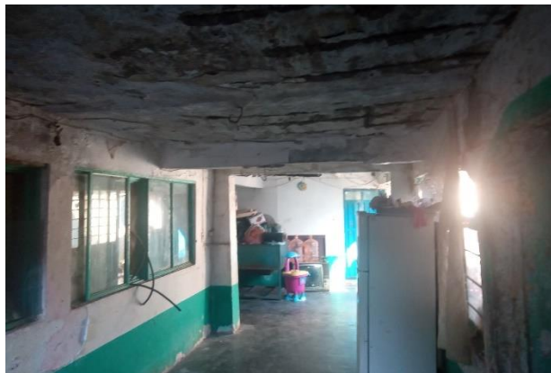
Ilustración 3. Travesaños con grietas horizontales y verticales ya muy pronunciadas. (18.952114, -98.979683).
