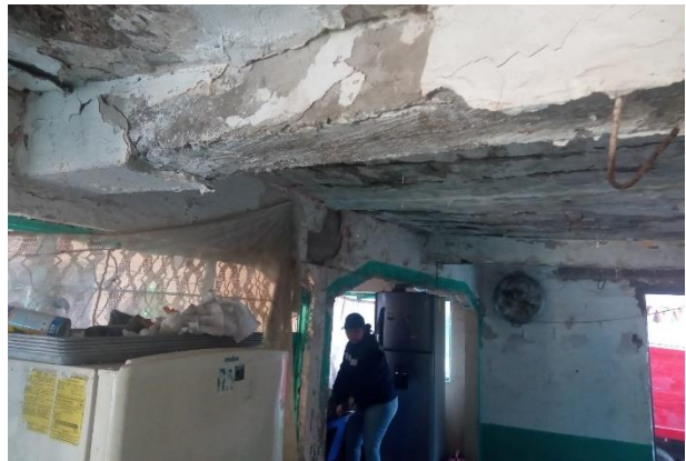
Ilustración 4. Travesaños con grietas horizontales y verticales ya muy pronunciadas. (18.952114, -98.979683).
