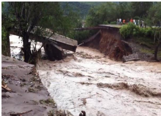
Imagen 21. Derrumbe de puente en Petaquillas
