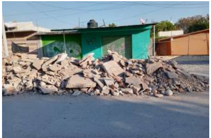
Figura 2. Disposición inadecuada de RCD en vía pública
