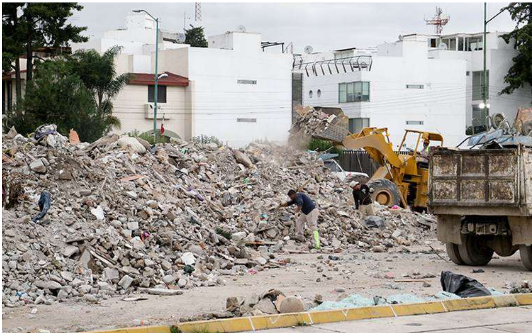
Figura 11. Disposición en vía pública de escombros generados por el sismo de 2017
