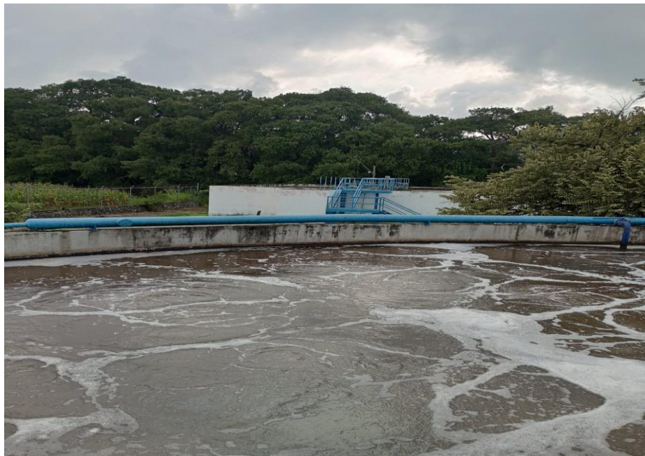
Ilustración 2-6. Reactor Aerobio de PTAR Gachupina, Jiutepec
