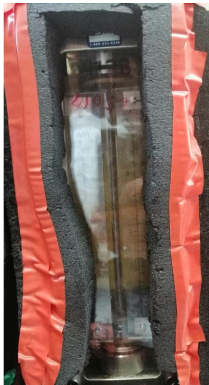
Figura 3.13 Flujómetros de calentamiento.
