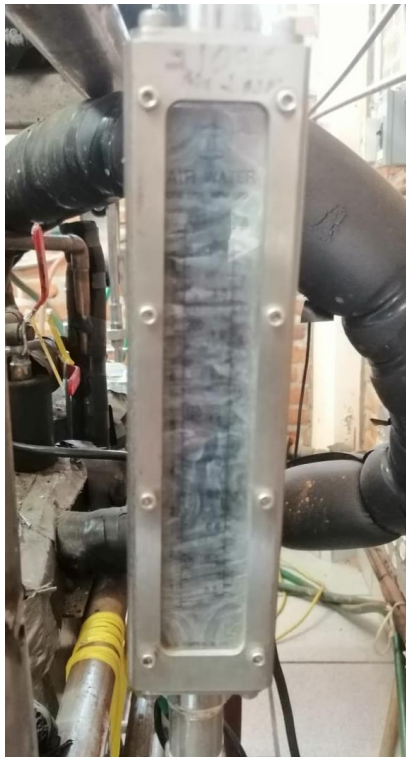
Figura 3.14 Flujómetro de enfriamiento.
