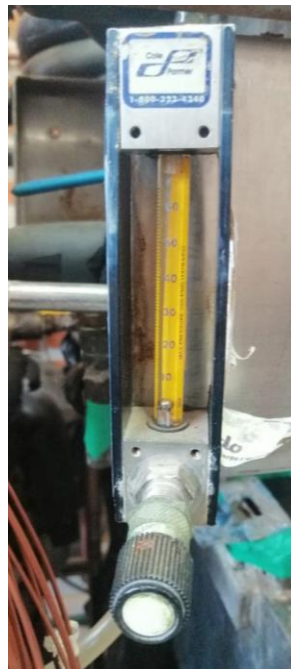
Figura 3.15 Flujómetro de la recirculación y del circuito de purificación.
