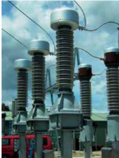
FIGURA 23. Transformador de potencial tipo inductivo.
