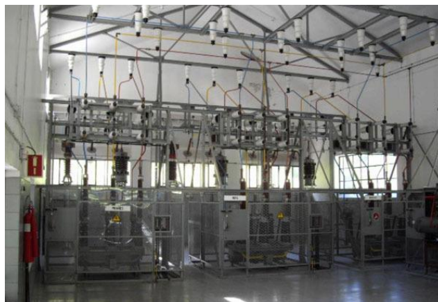
FIGURA 4. Subestación eléctrica tipo interior.
