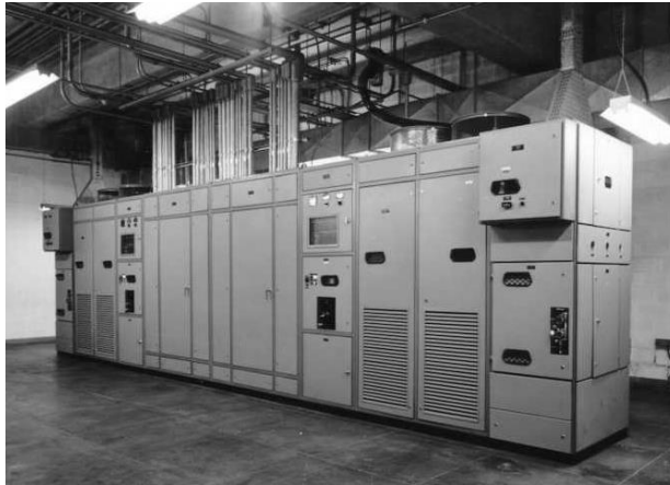
FIGURA 5. Subestación eléctrica blindada o compacta.
