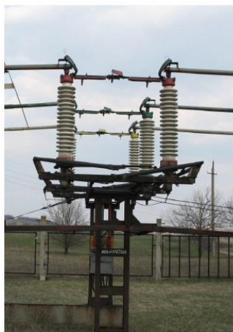
FIGURA 19. Cuchilla seccionadora o desconectadora.
