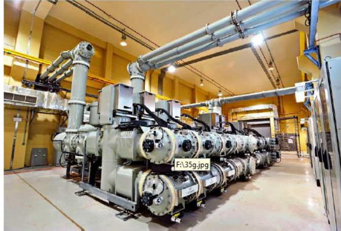
FIGURA 6. Subestación eléctrica encapsulada o aislada en gas SF6 (GIS).
