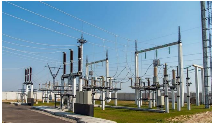
FIGURA 3. Subestación eléctrica tipo intemperie.
