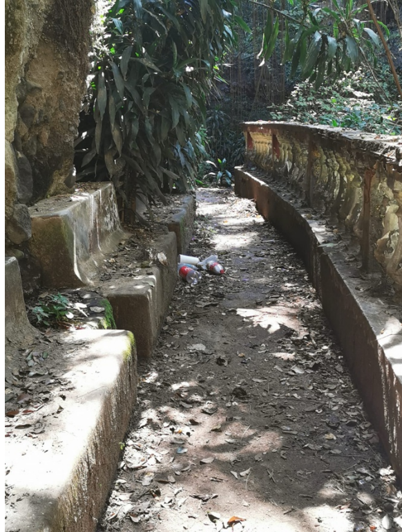
Fig. 35. Deterioro extremo de El Salto. Fuente: autora.
