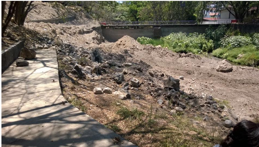
Fig. 45. Deterioro en parque Chapultepec a causa del “paso exprés”. Fuente: 24 Morelos.
