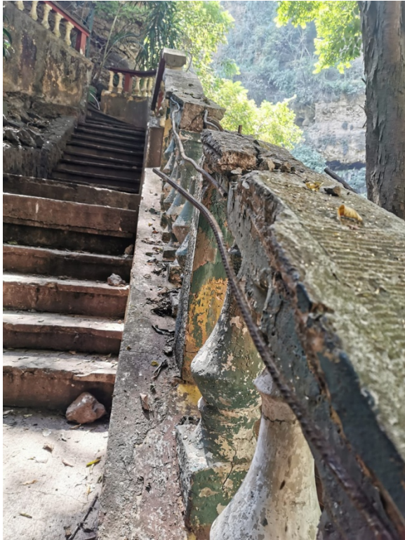
Fig. 34. Deterioro extremo de El Salto. Fuente: autora.
