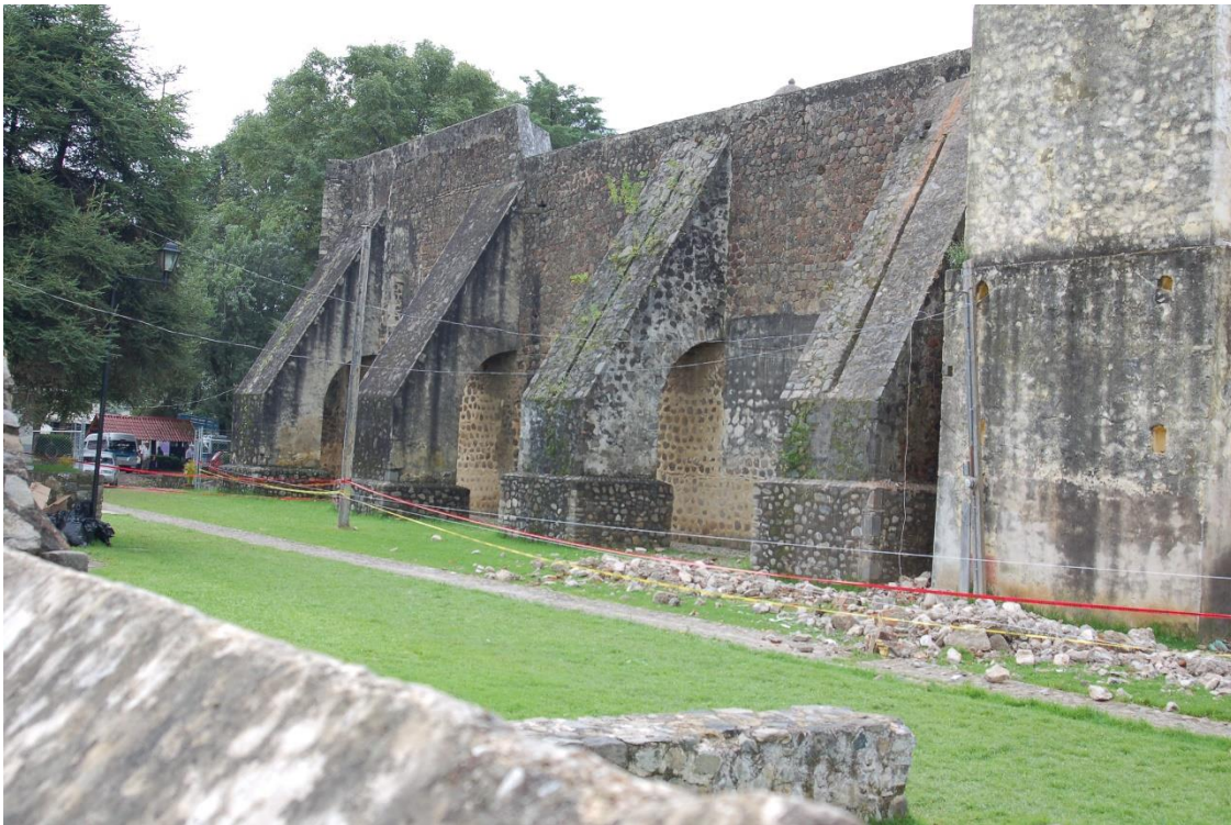
Fotografía 14. Contrafuertes sobre muro noreste, del convento de San Juan Bautista en Tetela del volcán. Autor, sept 2017.
