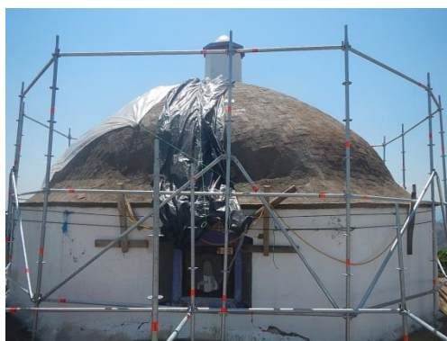
Fotografía 49. Olinalá Gro. Cúpula con daños por sismo, aspectos fallidos: geometría y materiales, autor 2018
