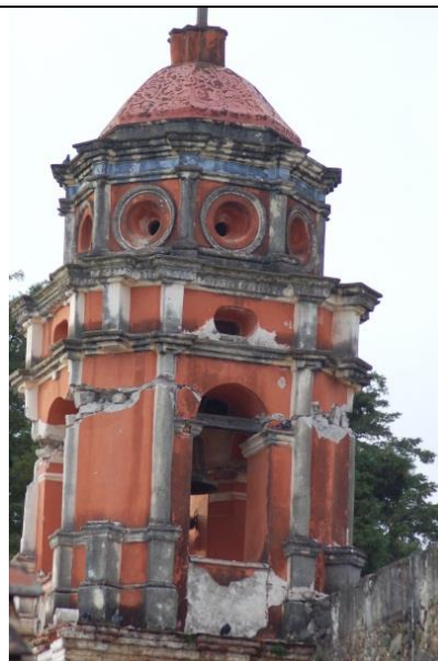
Fotografía 35. Convento de Santo Domingo de Guzmán, se aprecias los daños que sufrió el campanario, fotografía tomada el día 19 de septiembre 2017. el autor 2017.
