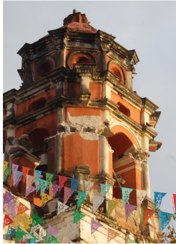
Fotografía43. Muestra los daños en el campanario, Hueyapan, Morelos, autor 2017
