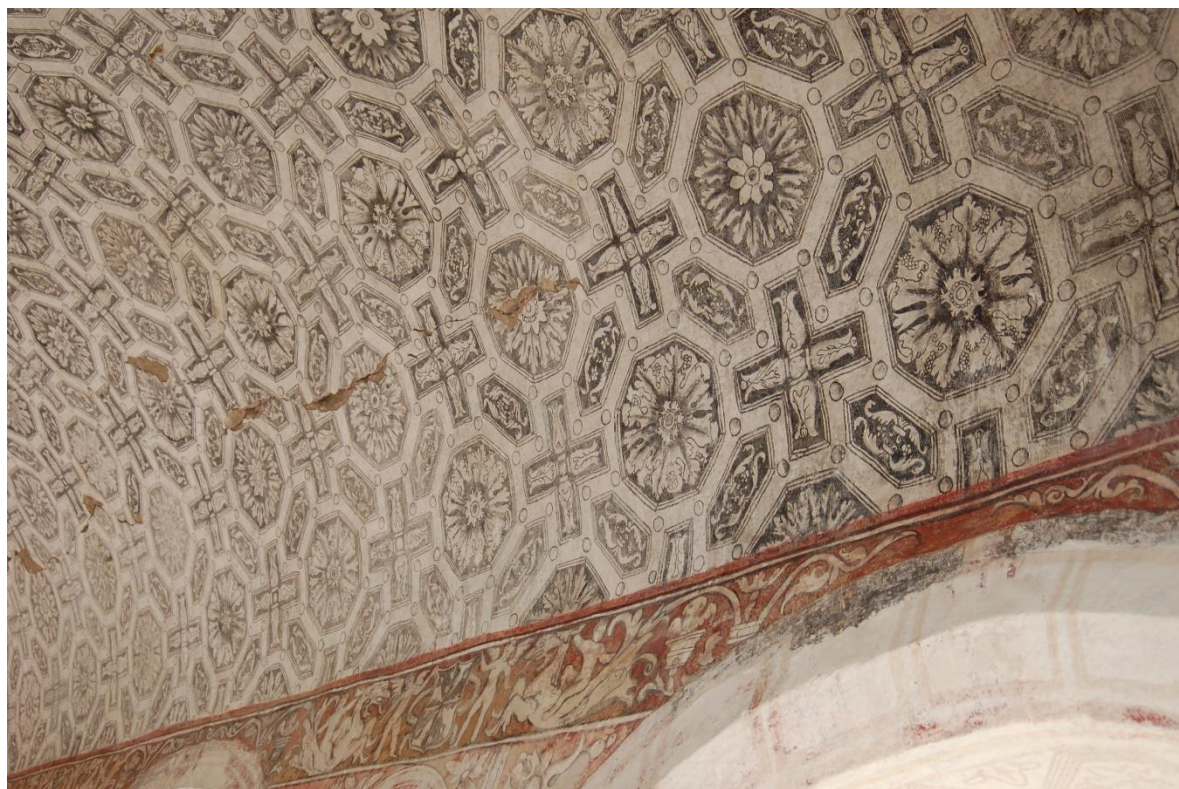
Fotografía 17. Grietas en pintura mural en lecho bajo de bóveda de cañón corrido en claustro bajo. Autor 2017
