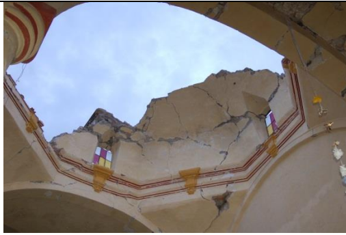
Fotografía 44. Se aprecia el colapso de la cúpula central, Hueyapan, Mor. autor, 2017
