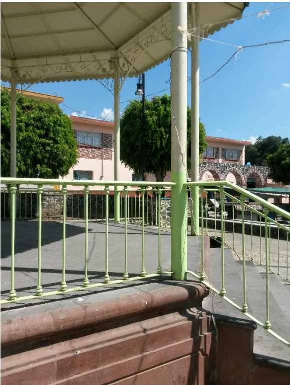
Detalles constructivos del kiosco. Fotografía Miguel Angel Gaona Aguilar- Rogelio Bahena Miranda 2015.
