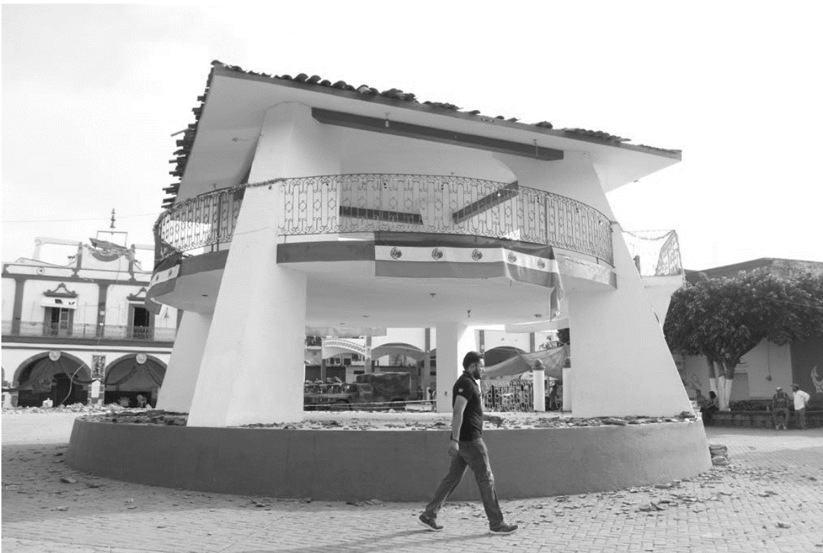
Los severos daños del kiosco a consecuencia del terremoto del 19 de septiembre de 2017.
