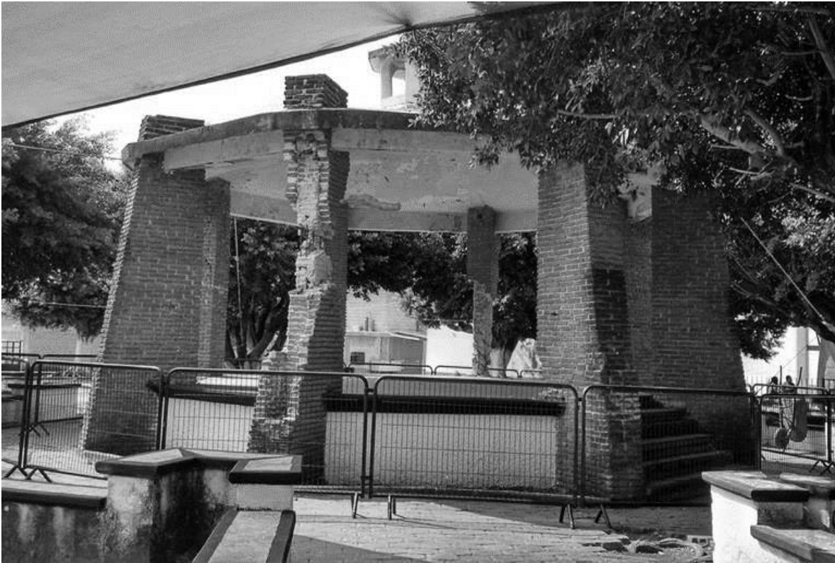
El kiosco en condiciones de peligro para los transeúntes. Fotografía Angelina Albarrán, "El sol de Cuernavaca"
