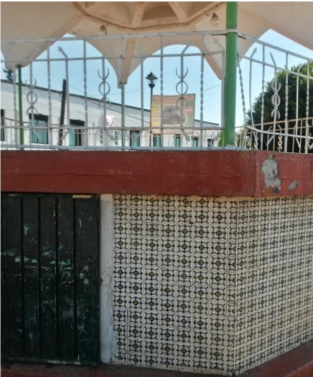
El deterioro en algunas partes de kiosco. Fotografía Miguel Angel Gaona Aguilar- Rogelio Bahena Miranda 2015.
