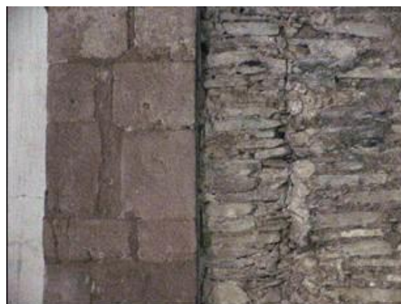
3.15.- Junta constructiva donde se demuestra que la nave y el presbiterio se construyeron en diferentes épocas. Fotografía del autor, 2003.
