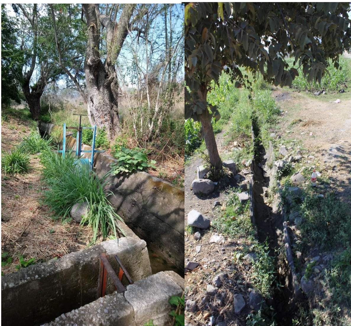
Fotografía 10. Ejemplo del estado de compuertas y canaletas, Coatetelco Morelos. Autor: Ana Tinoco. 04/ 2021
