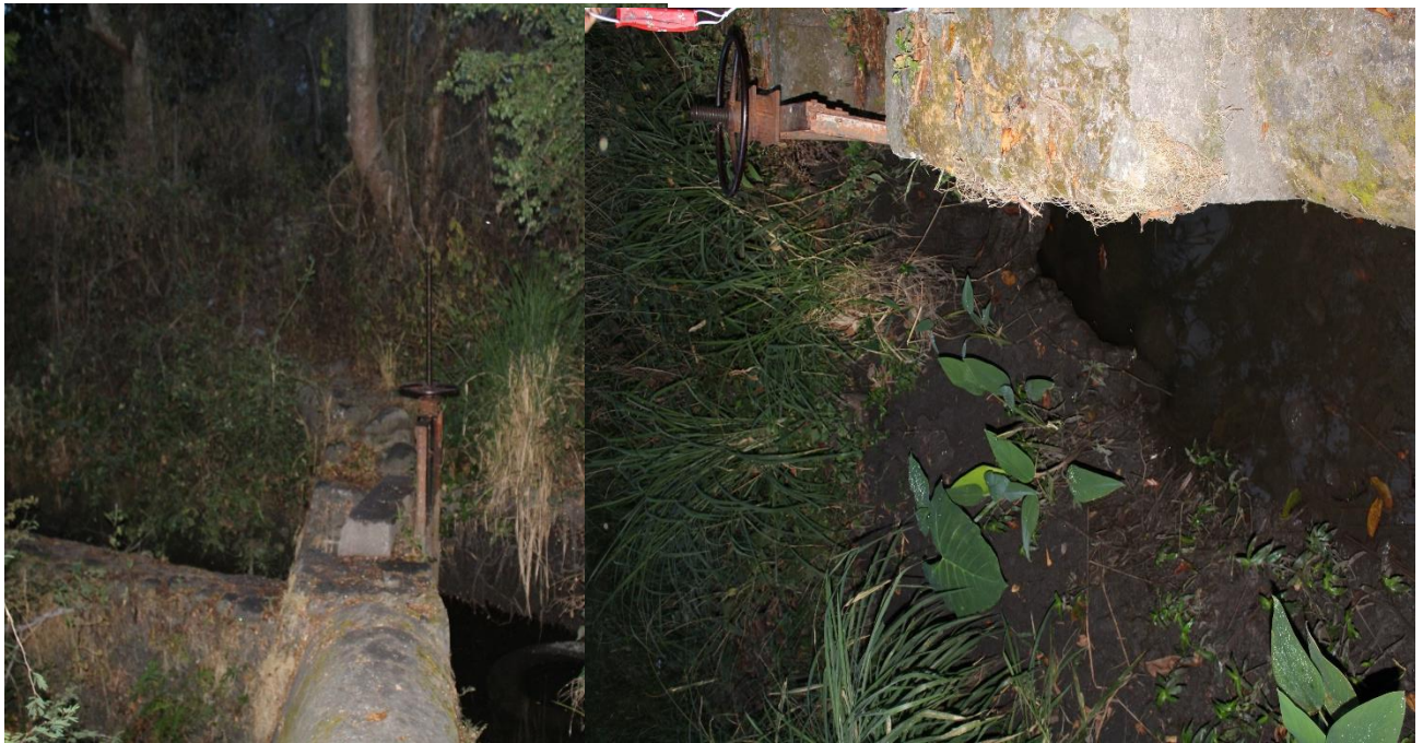
Fotografía 9. Primeras compuertas para distribución del agua rodada a los dos canales secundarios, Coatetelco, Morelos. Autor: Jorge Olvera. 06/ 2020
