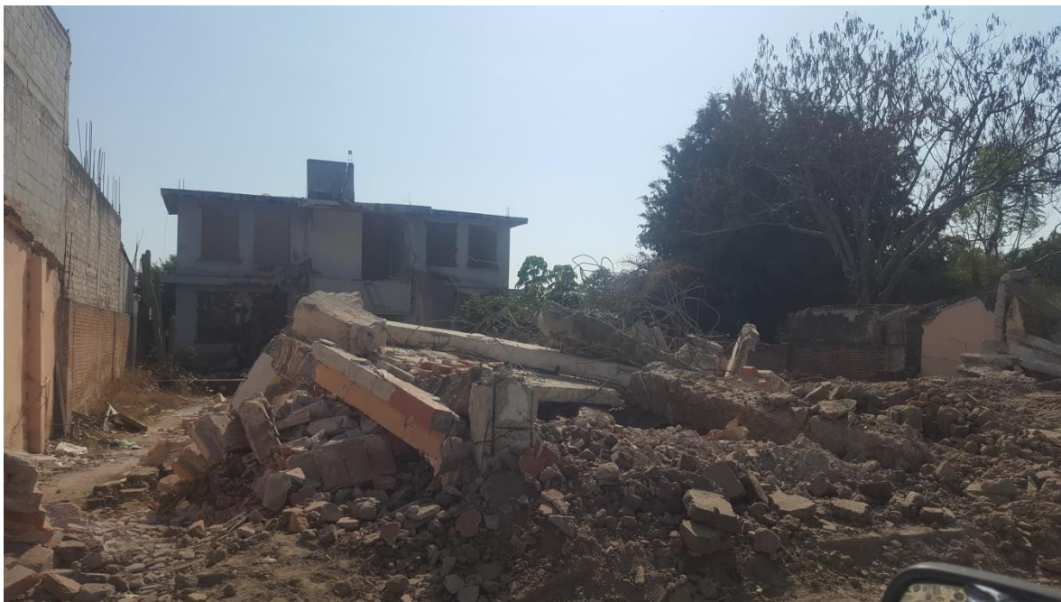
Foto 11 Construcciones de Tlayehualco, casas colapsadas en su totalidad. Muchas casas en Contla y Tlayehualco tuvieron que ser derrumbadas. Noviembre 10 de 2017. Foto: Israel Zumaya
