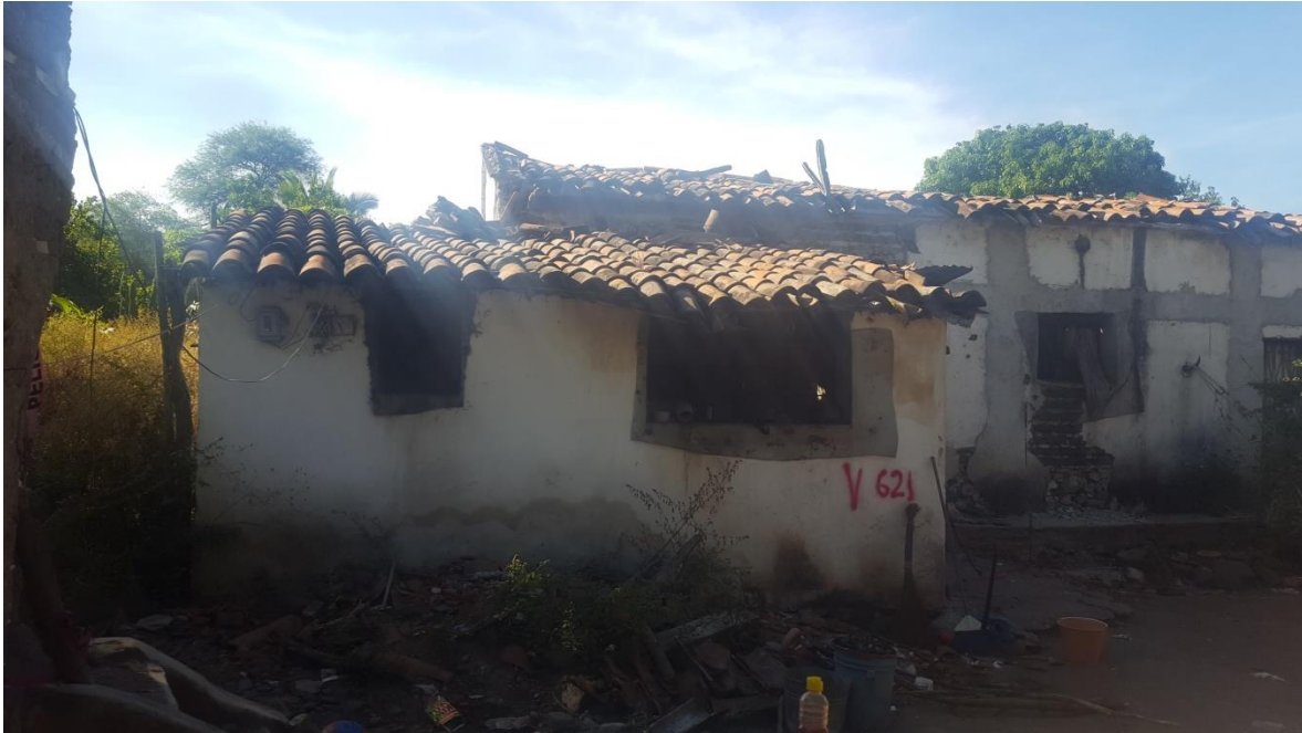
Foto 12 Casa de Doña Chuy en Tlayehualco, esta casa quedo completamente dañada, se puede observar el tipo de construcción y los materiales, muros de adobe, construcción mixta, sin cadenas de cierre. En este terreno se levantó la nueva casa de Doña Chuy. Foto: Israel Zumaya
