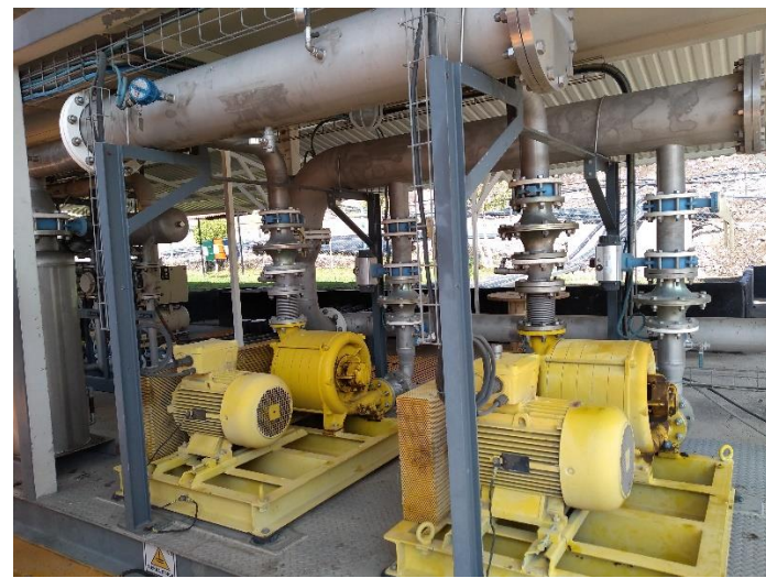
Figura 12. Relleno Sanitario "La Perseverancia". Generación energía
