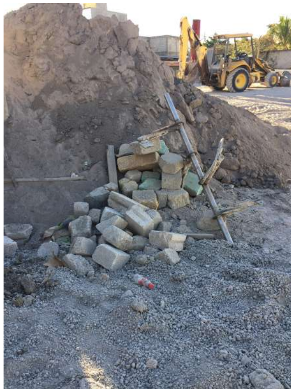
Fotografía 12. Residuos de mezcla seca
