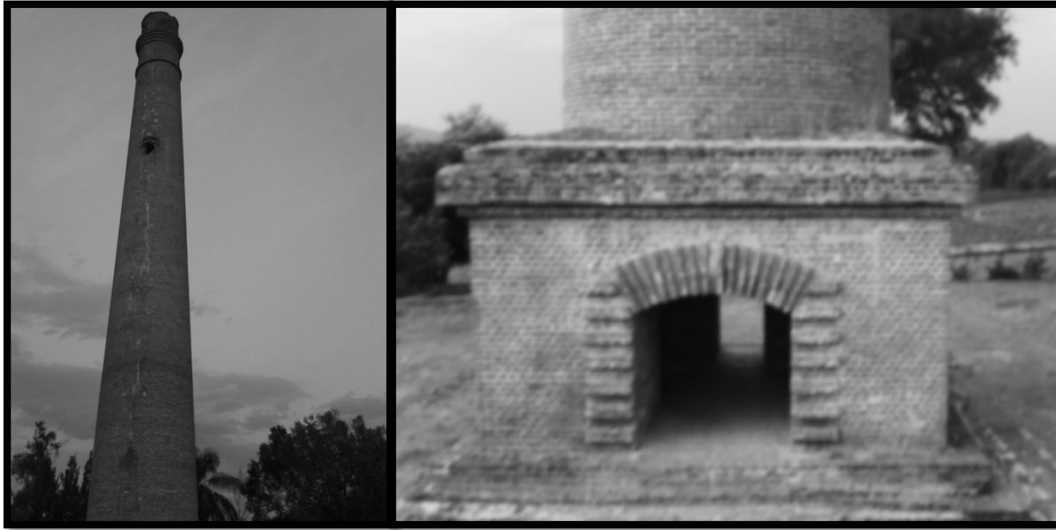
Figura 20. Daños y deterioros del chacuaco Chinameca
