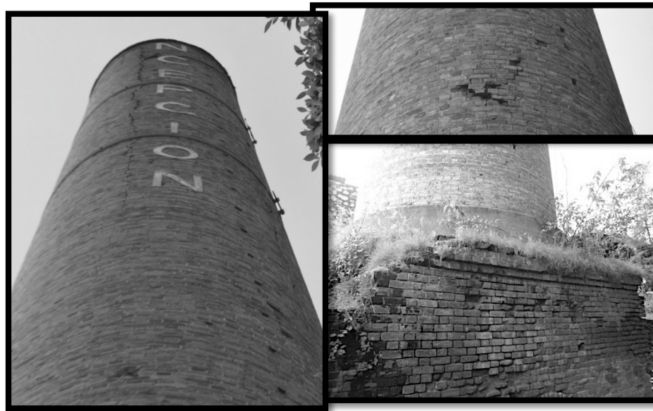
Figura 15. Daños y deterioros del chacuaco El Hospital
