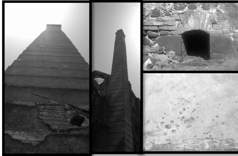
Figura 30. Daños y deterioros del chacuaco Cuahuixtla
