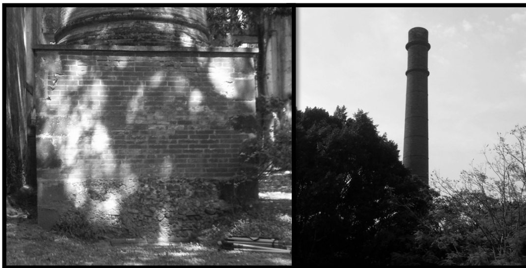
Figura 25. Daños y deterioros del chacuaco Atlihuayan
